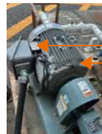
屋外給水ポンプへの設置例
